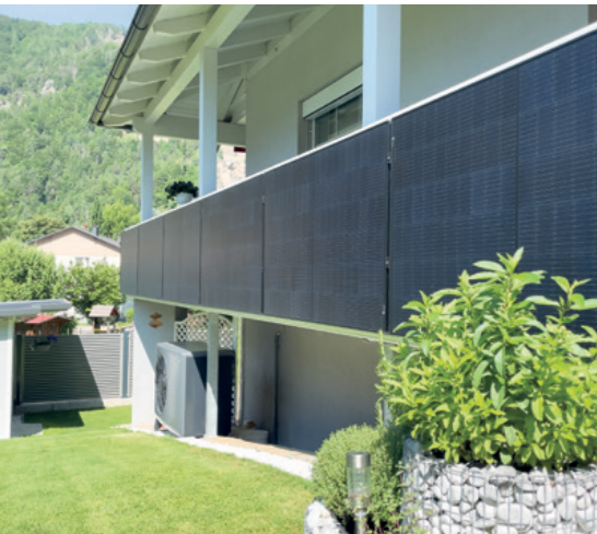
SONNENKRAFT PV-Balkon und Luftwärmepumpe
